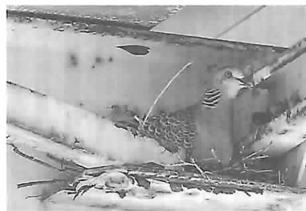
写真2 鉄骨の梁に巣作り
